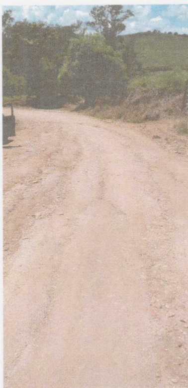
TRECHO CASCALHADO – SEM SAÍDA D'ÁGUA
